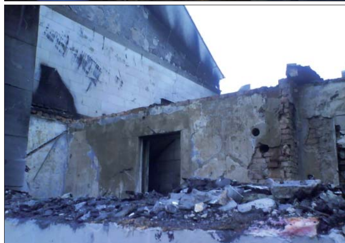
Záběry vyhořelého domu
