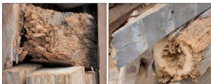
Fotky poškozených trámů
